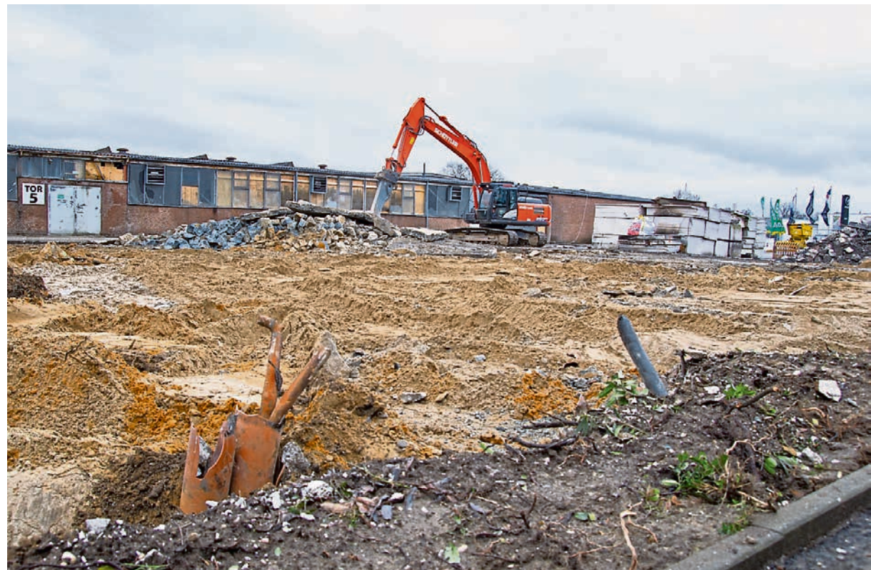
So sieht es derzeit auf dem Isseltrans-Gelände aus, wo vor über vier Monaten eine Halle abbrannte. FOTO: FRITHJOF NOWAKEWITZ
