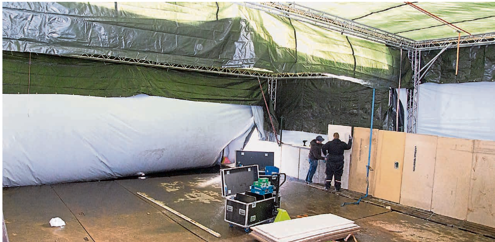
Bei Isseltrans wird alles vorbereitet, um die durch den Brand mit Asbest verseuchten Metallteile reinigen zu können.
